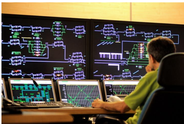
Figure Salle de commande sur le palier N4
